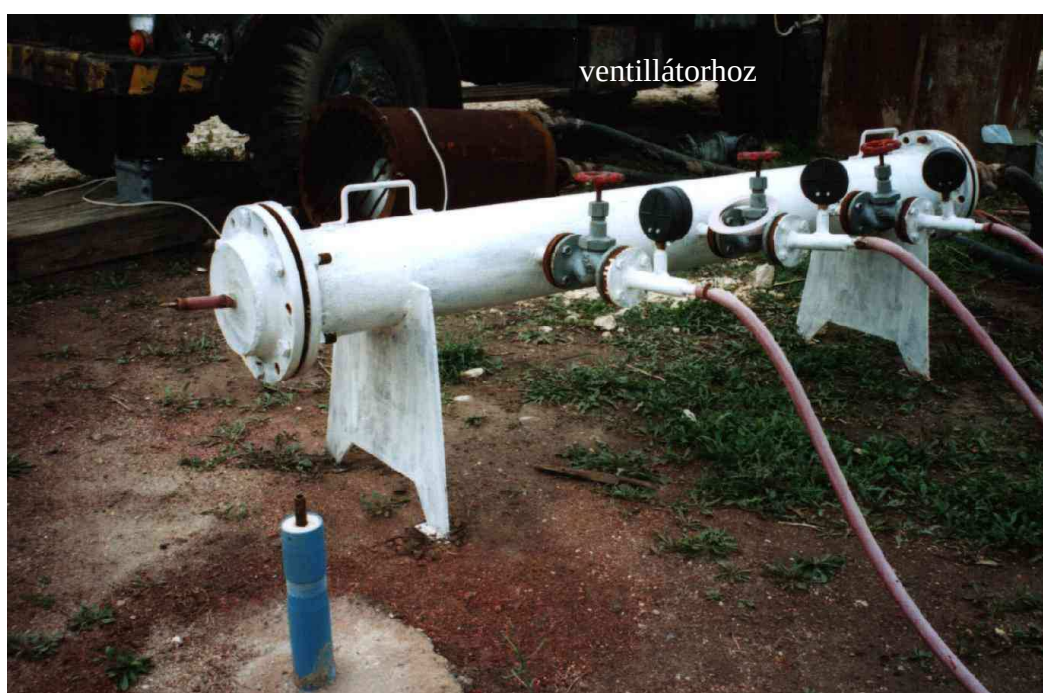
10 ábra: Levegőztető kút felszíni csővége és a levegőgyűjtő rendszer
